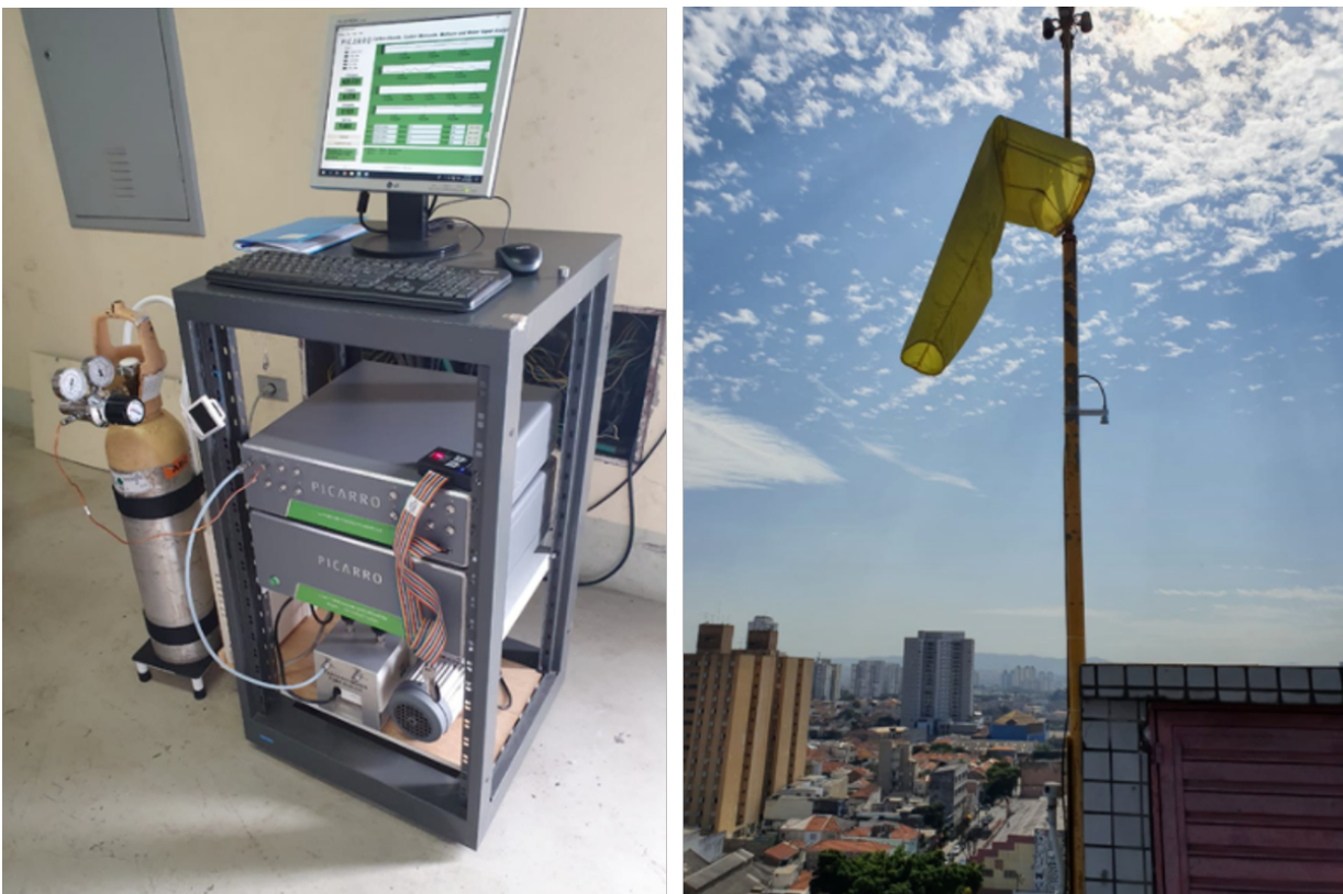
Figura A.3: Imagens da estação de medição UNICID
